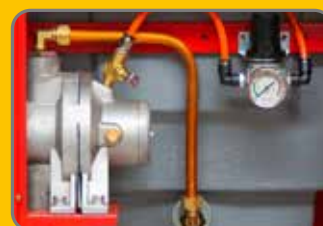
Détail de la pompe à membrane et du régulateur de pression.
